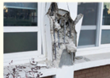
• 흥해초등학교 건물 기둥 파손
