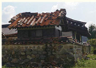
• 사마소 지붕 기와 파손
