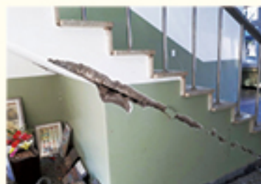
• 포항흥해공고 계단 균열
