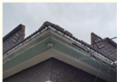
• 주택 지붕 난간 파손
