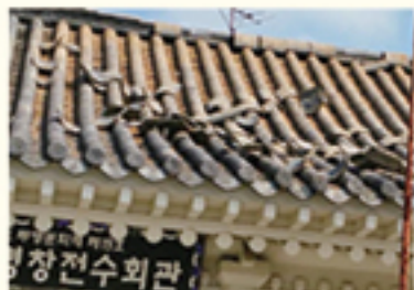
• 무형문화재 전수관 지붕 기와 파손
