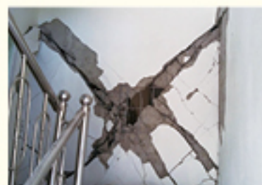
• 장량동 기예공 주택 내벽 파손
