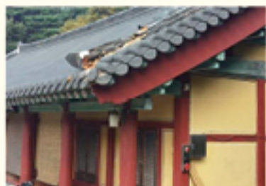
• 불국사 지붕 기와 파손
