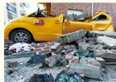
• 조계도 외벽 파손으로 인한 차량파손
