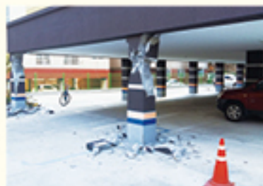
• 장량동 크리스탈 필로티 기둥 파손
