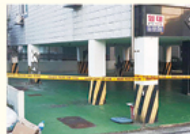
• 장량동 오서빌 필로티 파손
